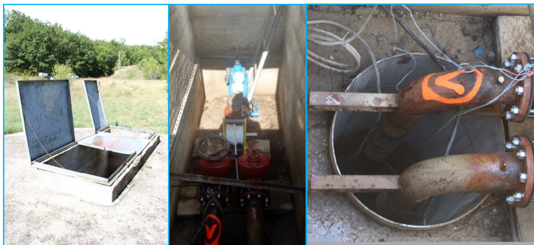
Photo 12 : photographies du forage de La Fare
