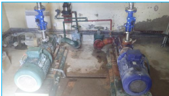
Photo 4 : pompes de refoulement
